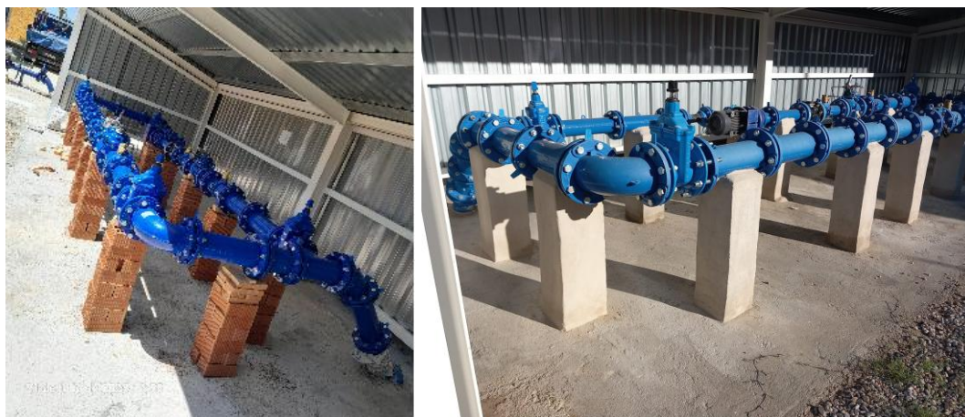
Figura 16. Turbina Instalada en Benimàmet. C/ Cullera, Pozo de Benimàmet
