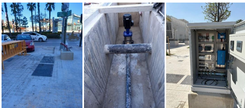
Figura 8. Turbina Instalada en Valencia. C/ Camp del Túria - Av. Cortes Valencianas. Fuente: Propia
