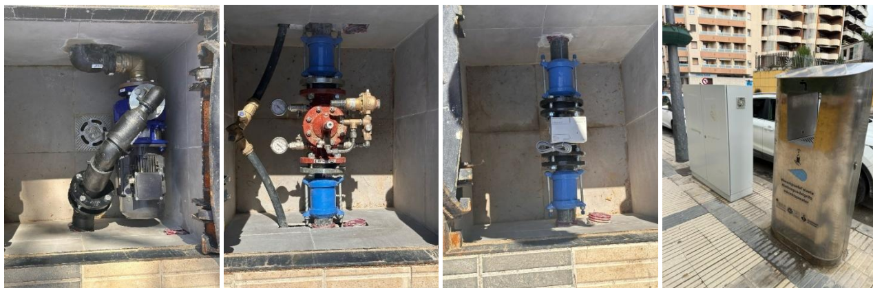
Figura 7. Turbina instalada en Tortosa. Fuente: Propia
