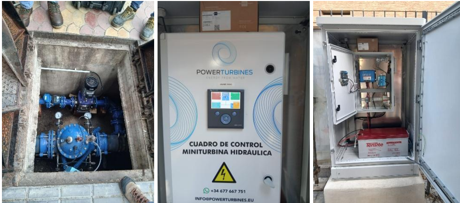
Figura 13. Turbina Instalada en Valencia. C/ Gascó Oliag – Av. Primado Reig Fuente: Propia
